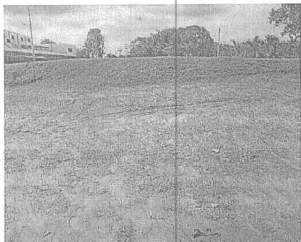
Foto 3. Tomada el día 29 de agosto de 2017. Talud externo de las lagunas de oxidación. Se está adecuando el terreno para evitar futuros empozamientos de agua lluvia.
